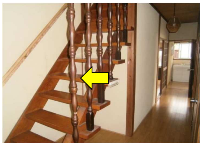
補修箇所：手すり ※1本ぐらつき有り
