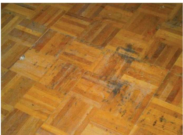
台所（一部に剥がれ・浮きあり）
