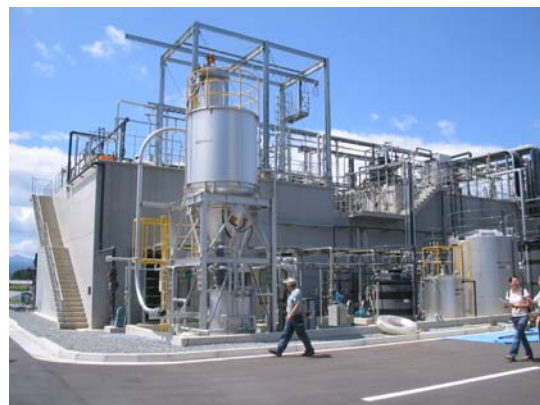
排水処理施設 現在は下水処理して放流するが、近い将来は液肥として活用する
