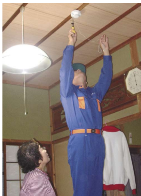
火災警報器の取付けができない世帯には、団員が出向いて取り付けました
