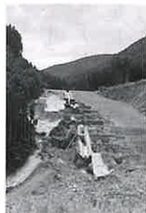
被災箇所の再崩壊
