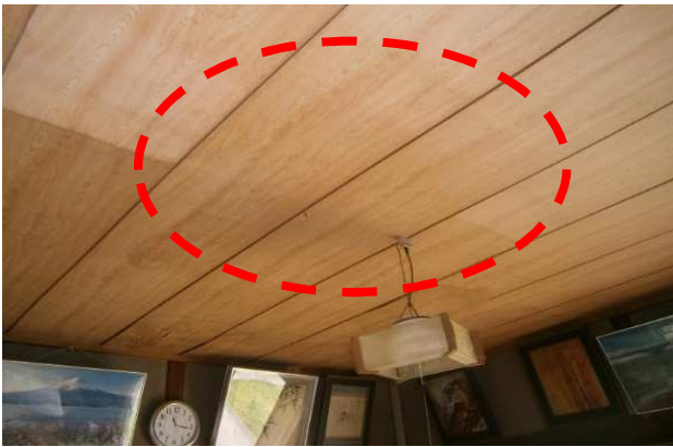
要修繕（和室天井雨漏り）
