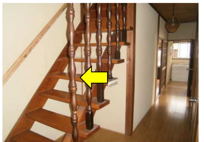
補修箇所：手すり ※1本ぐらつき有り
