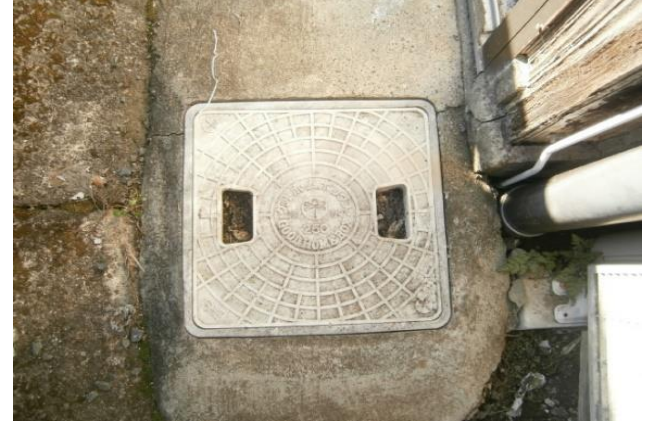
玄関横雨水樹
