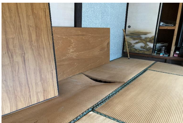
8畳和室 畳劣化部
