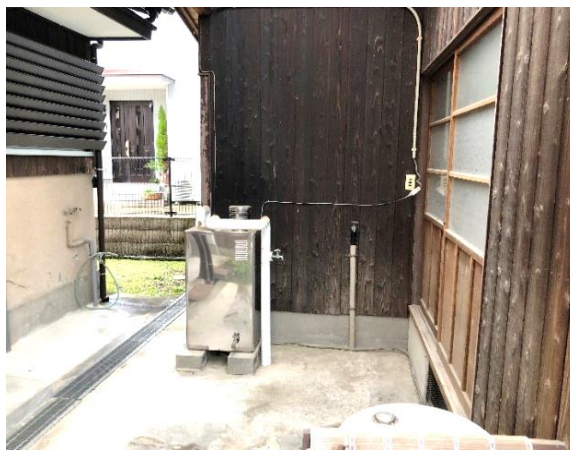
倉庫・灯油給湯器
