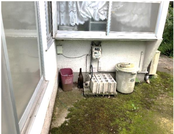
プロパンガス施設
