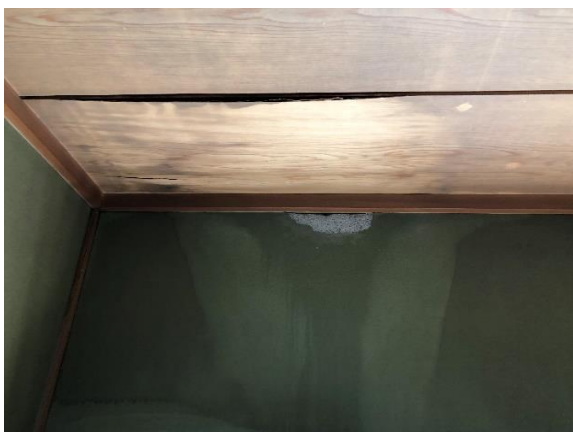
和室A 天井雨漏り跡
