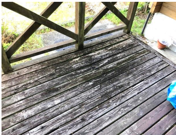
ウッドデッキ要修理
