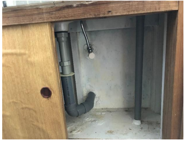
手洗い水道管要補修
