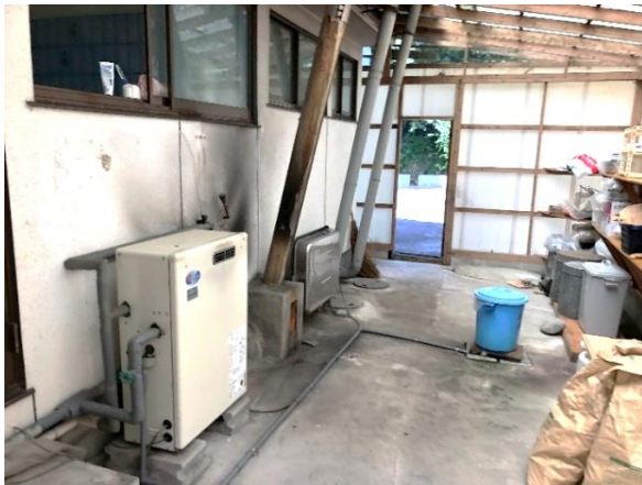
灯油ボイラー・便槽
