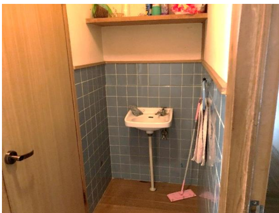
トイレ手洗い
