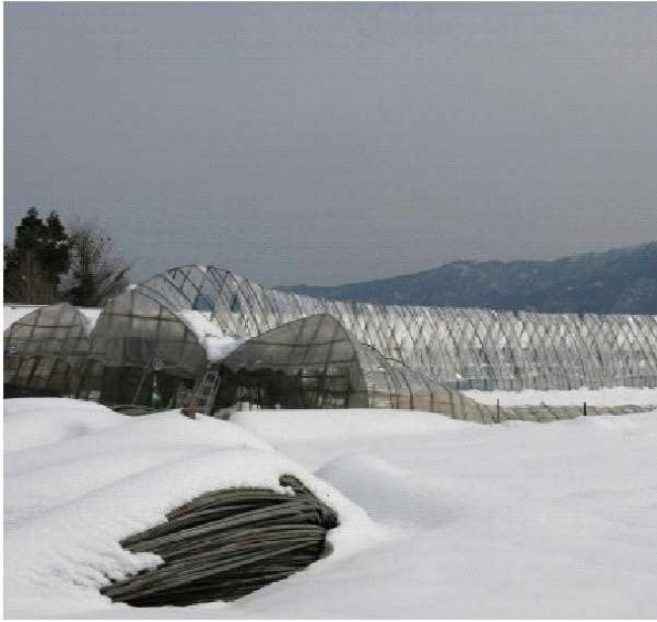
写真14 ビニール切断したが倒壊した 連棟ハウス
