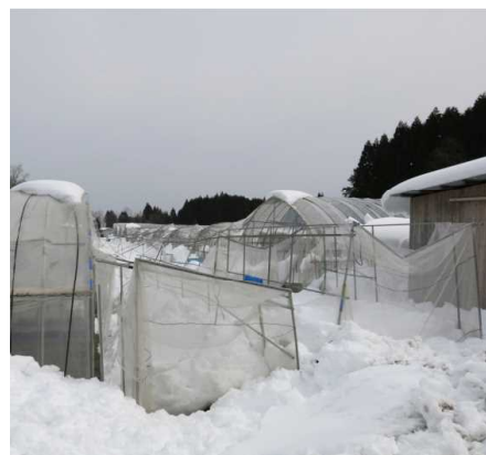
写真6 防虫ネットの積雪被害
