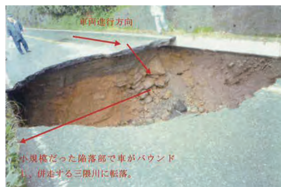
(夜明中町) ・国道386号線陥没現場。 ※事故当時の陥没は半分程度の規模であったと考えられる。
