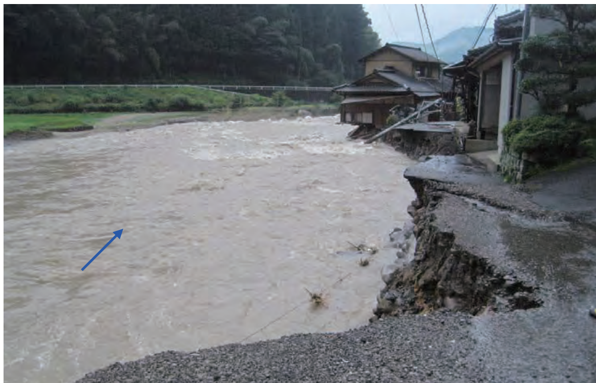
写真－2.6.6 小野川の被災状況(柳野) 3)
