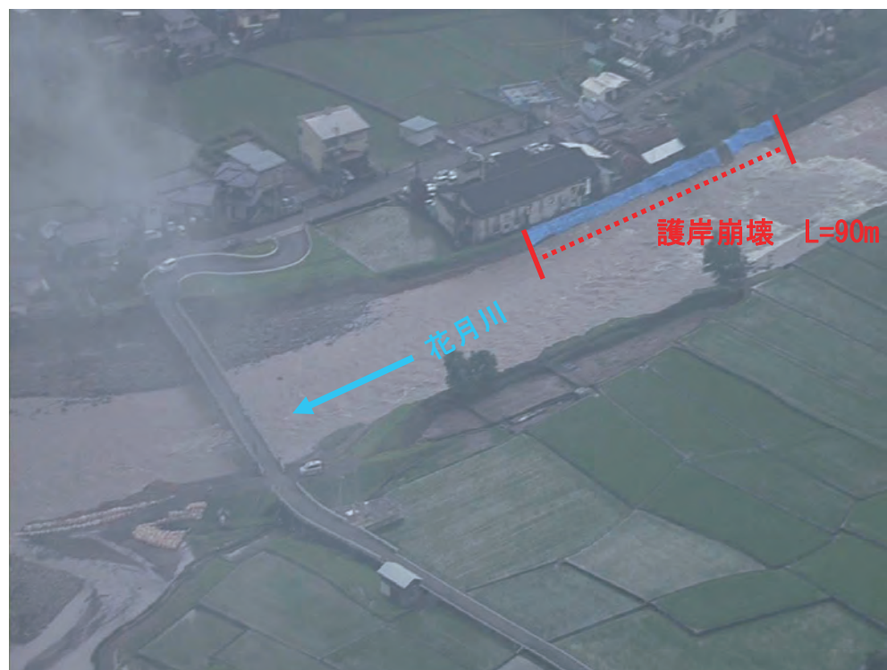
日田市三花地区(花月川 右岸8K100付近) 護岸崩壊状況
