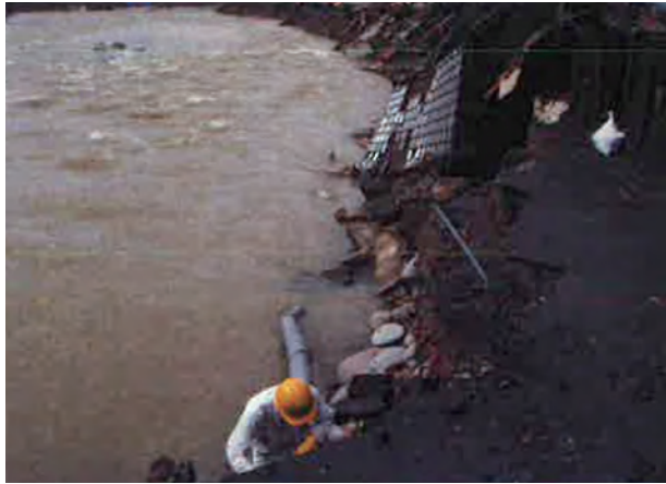
・清水町住吉地区下水道管切断
