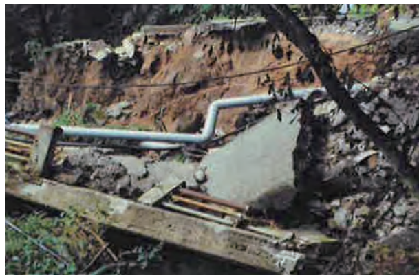
・深谷橋水道管流失(仮設状態)
