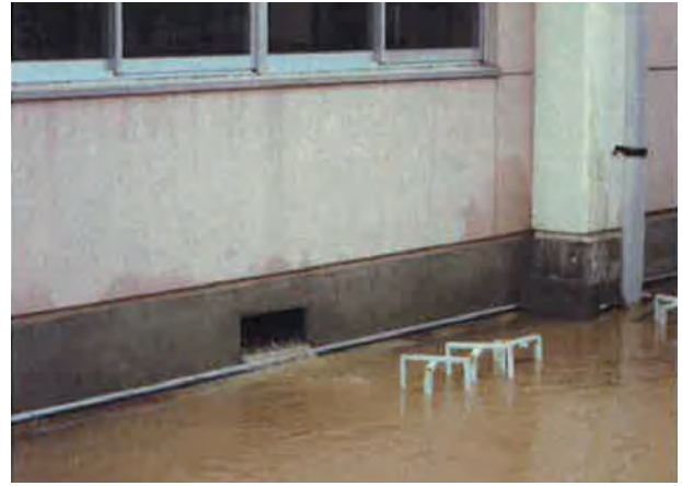
・床下浸水した光岡小学校校舎
