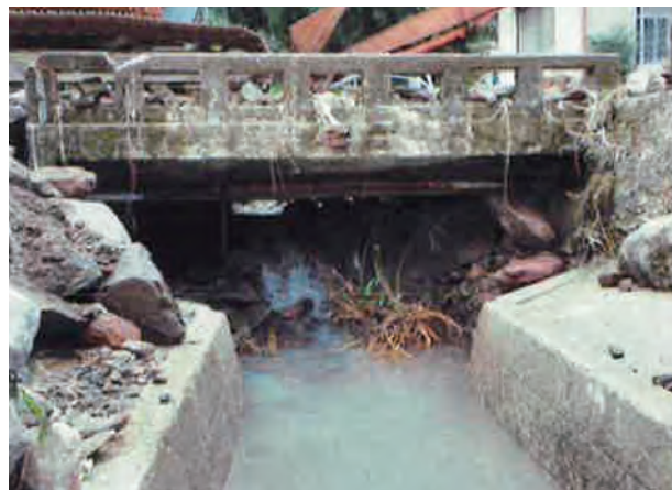
・天瀬町簡水被災状況
