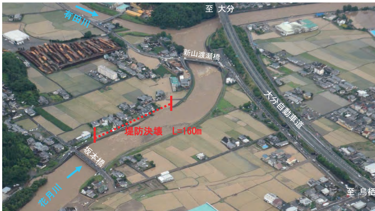
日田市西有田地区(花月川左岸 5K800付近) 堤防決壊状況
