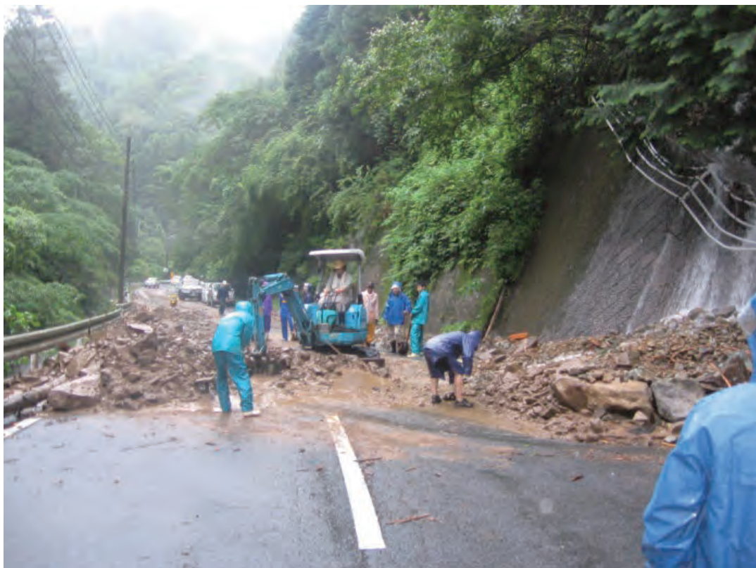
写真－2.7.5 県道宝珠山日田線の被災状況(大字小野) 3)
