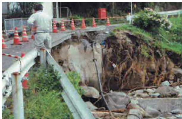
・殿町排水管流失
