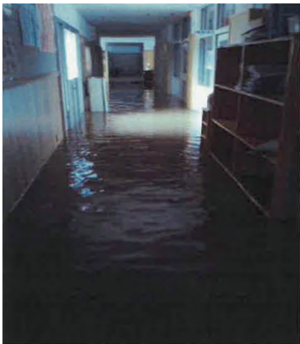
・冠水した北部中学校1階廊下
