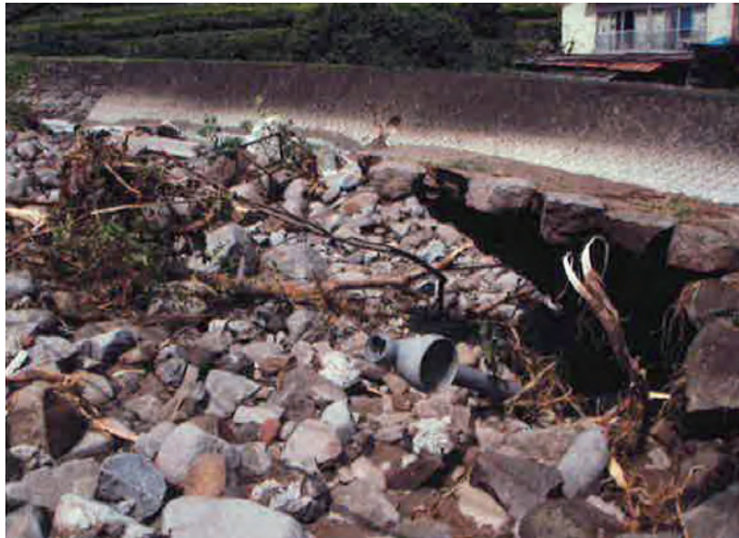
・大山町錦打地区下水道管流失
