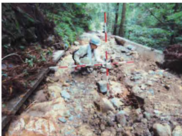
・前津江町（林道千蔵木線 起点0.4km付近）
