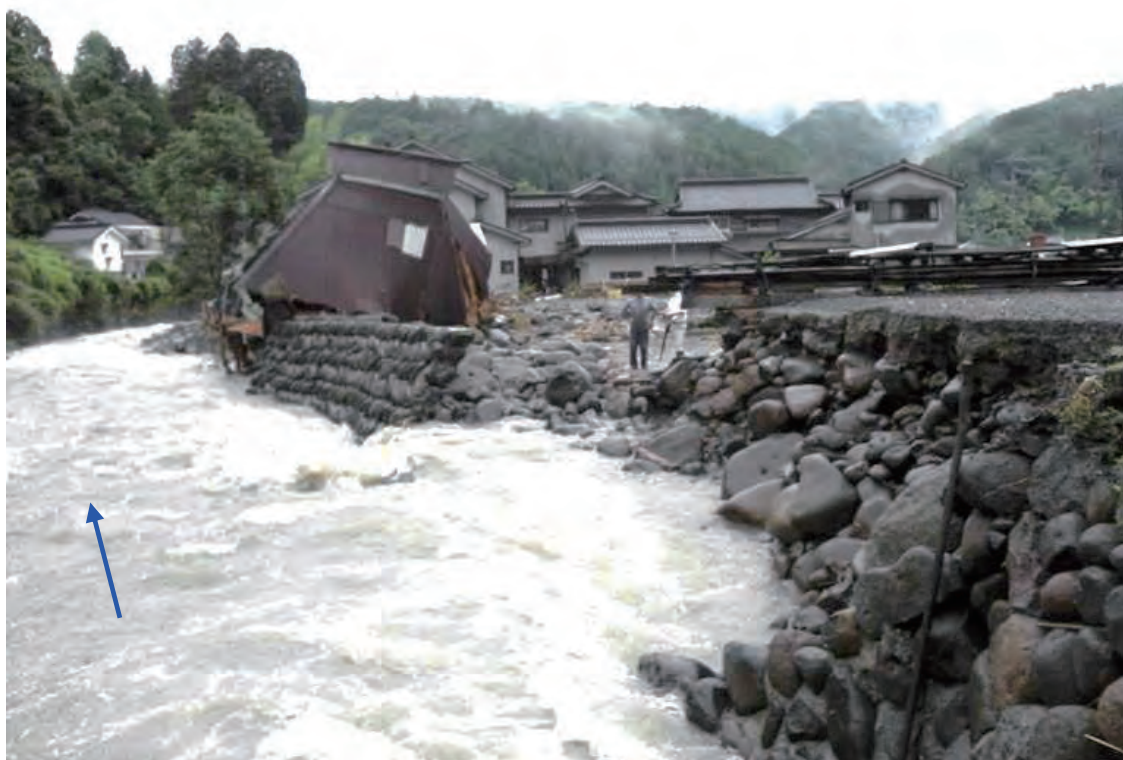
写真－2.3.2 熊尾川の護岸被害と住家被害 3)
