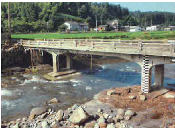
・日掛橋水道管流失
