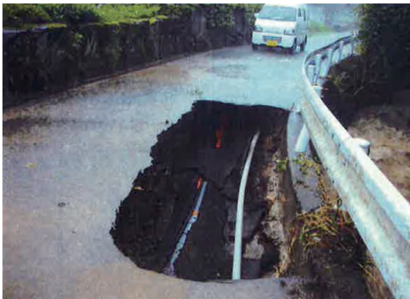
・大肥町白岩地区道路陥没による下水道管破損
