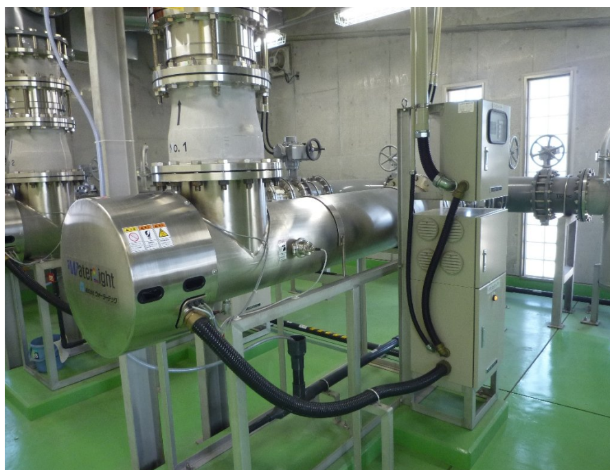
《竹田浄水場 紫外線処理設備》
