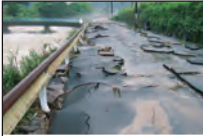
小野地区 小野川のはん濫によりアスファルトが浮き上がった県道。
