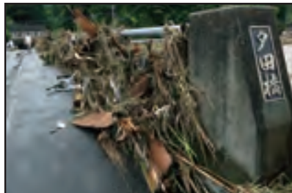
西有田地区 夕田橋に大量の流木がひっかかり、川の流れをせき止めた。
