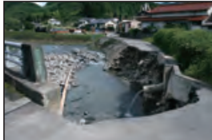
五和地区 内河町の橋。道路が寸断され、先に進めなくなりました。
