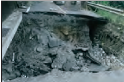
光岡地区 道路が陥没し、通行ができなくなった国道386号線。
