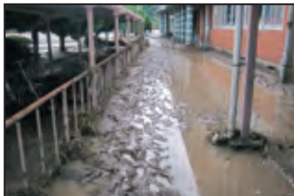
西有田地区 ピーク時は約1mの高さまで浸水した北部中学校。
